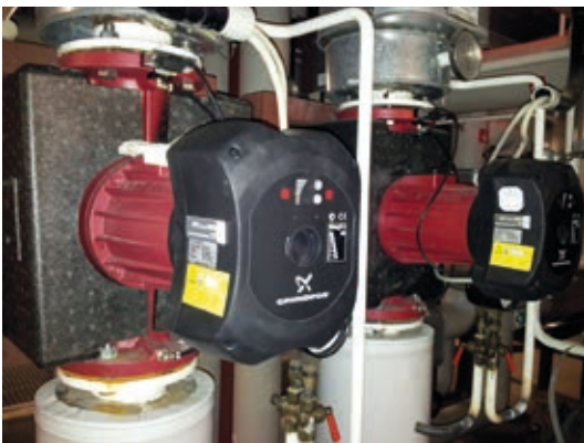
Maßnahme als ÖKOPROFIT Einsteiger: Einsatz hocheffizienter Heizungsumwälzpumpen anstatt herkömmlicher Pumpen
