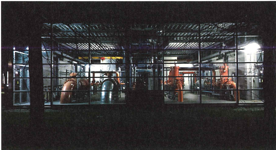
Abbildung 5: Gasdruckregelstation auf dem M.Campus
