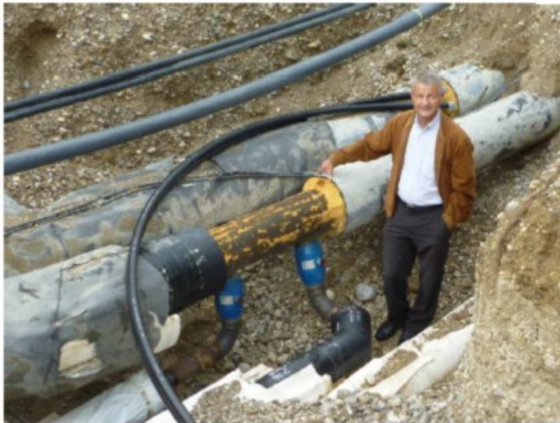
Ungewöhnliche Verzweigungen der Fernwärmerohre: Wilfried Ebster, Entwickler des Konzepts und Gewinner des Bayerischen Energiepreis 2012 zeigt, wie am Fernwärmerücklauf nochmals Wärme "abgezweigt" wird, um auch noch die Energie des Rücklaufs auszunutzen.
