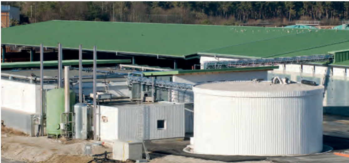
Trockenfermentationsanlage des AWM
