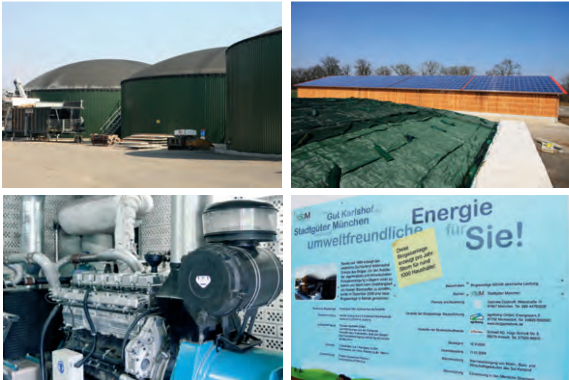
Von links oben im Uhrzeigersinn: Die Biogasanlage am Karlshof der Stadtgüter München; die PV-Anlage am Karlshof der Stadtgüter München zur Eigenstromerzeugung; Blockheizkraftwerk; Informationstafel zur Biogasanlage am Karlshof
