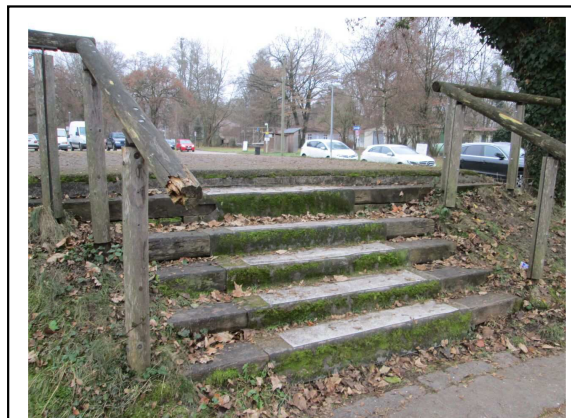
Rutschiger, gefährlicher Treppenaufgang
