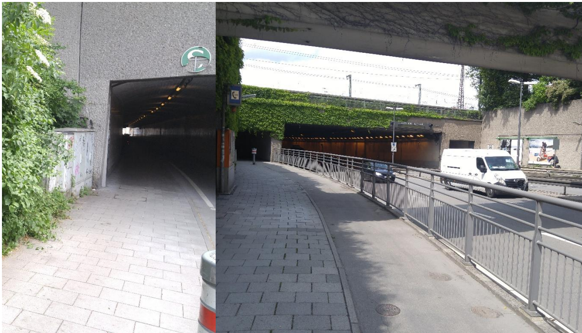
Fehlende, defekte und überwachsene Schilder
