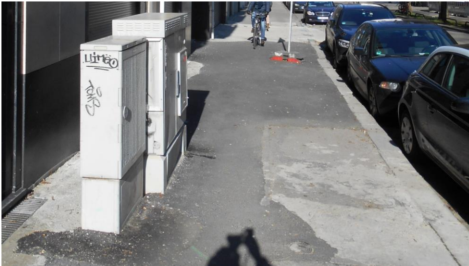
Abb. 2: Verteilerkästen vor Türkenstr. 9, Situation nach Neubau im April 2020
