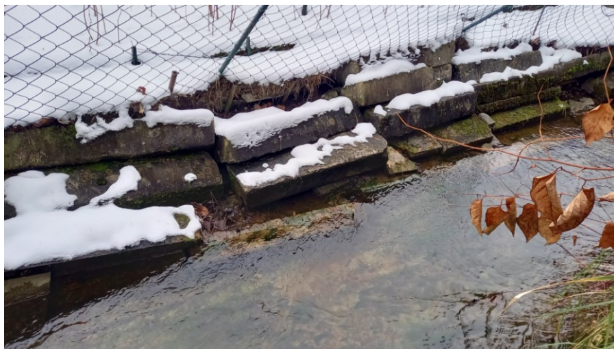
Bild 3 – beschädigte Uferböschung des Seitenarmes
