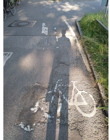
Abgetragene Bodenmarkierung (2) sowie Straßenschäden
