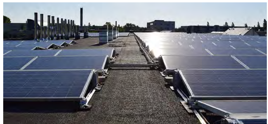
Die Photovoltaikanlage auf dem Dach der Bäckerei
