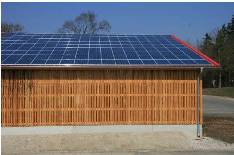
Strohalle mit Photovoltaik am Gut Karlshof
