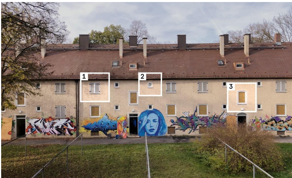
Abbildung 42 Potenzialanalyse Urban Mining im Entwicklungsgebiet Ramersdorf der Münchner Wohnen, Beispiel Analyse für die Anzahl der Fenster: Große Fenster (1): 56; kleine Fenster (2): 50; Flurfenster (3): 11.
